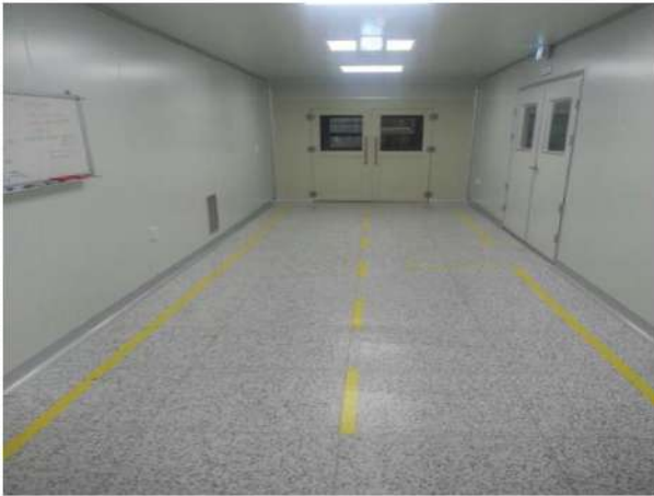
クリーンルーム
